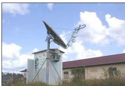
Source : Conseil Régional – Station satellite en site isolé
